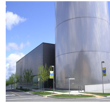
5000 ton chiller plant, 2 M gallon TES
